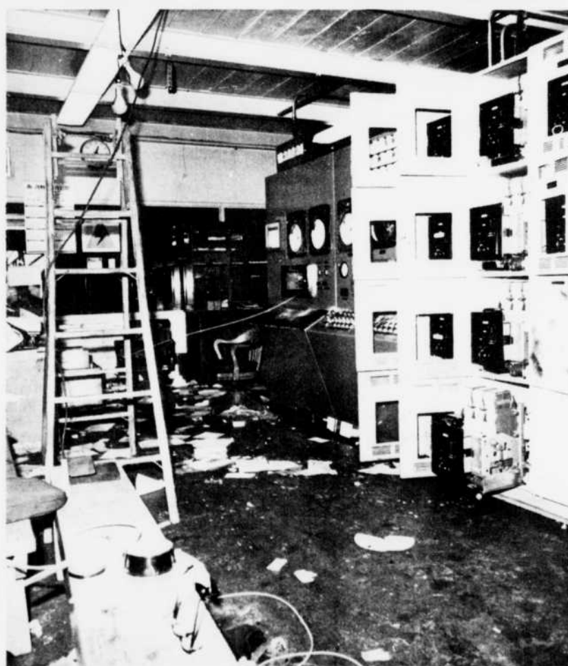
A la salle de contrôle de la station de pompage des bassins de sédimentation, tableaux, cadrans, voyants, boutons et tiroirs ont sauté sous les coups des malfaiteurs.
