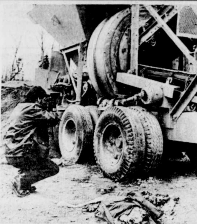
Les vêtements de la victime sont restés coincés dans les roulettes de ce concasseur à pierre, installé au beau milieu d'une terre agricole.
