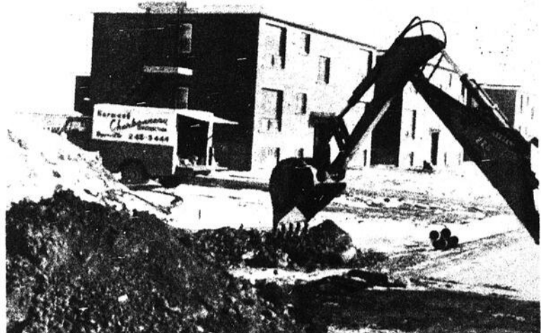
Dès mardi matin, la mise en place des ponceaux commençait dans la zone 4.
