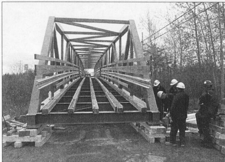
INSTALLATION - L'infrastructure permettra notamment aux cyclistes de traverser la Péribonka sans utiliser la route 169.
