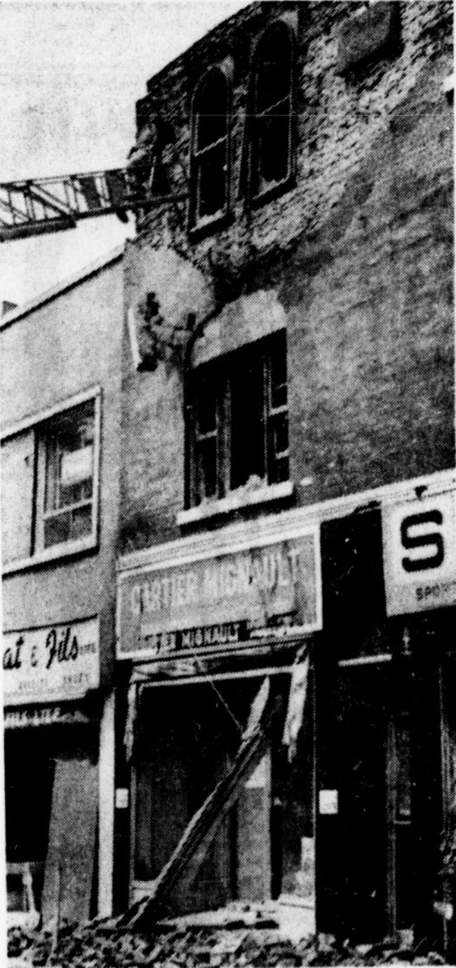
UNE BRIQUE SUR LA TÊTE — Il fallait éviter qu'une brique tombe sur la tête d'un passant. On en a donc enlevé le plus possible sur la façade de l'édifice de M. Laurent Pelchat qu'un incendie a complètement ravagé plus tôt cette semaine. C'est ce qui explique la présence de ce camion à incendie et de l'homme, en haut de la grande échelle. L'opération s'est déroulée jeudi après-midi devant quelques curieux. Selon M. Pelchat, l'édifice qui abritait les commerces Cartier Migeault et Stade Liée, 153 et 157 rue Principale, avait une valeur marchande de $120.000. Si l'on inclut les pertes des deux commerçants, ainsi que celles des deux autres locataires, le Salon de coiffure Paul De Rycke (155) et le magasin de meubles Jacques Lamont (21, rue Laval) on atteint facilement les $250.000. On ignore encore les dommages de l'édifice de la Banque provinciale du Canada, situé aux 159 et 161 Principale. Ils seraient considérables. D'ici peu, le chef du service des incendies de Hull, M. Roger Poitras, sera en mesure de dire de quelle façon les flammes ont pris origine. Entre-temps, il poursuit son enquête.
