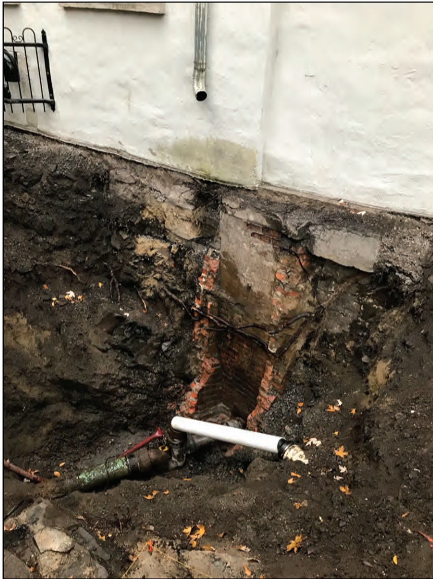
Photo 1 : Ancien égout en briques (13B100) adossé à l'aile des Parloirs, vers le sud-est.
