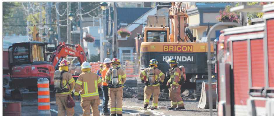
La fuite de gaz s'est produite à l'intersection de la 6 e Avenue et de la 1 re Rue, mercredi.
