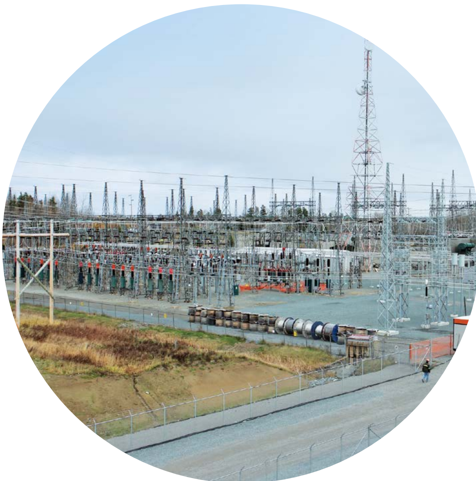
Le poste de Figuery, semblable au poste actuellement à l'étude
