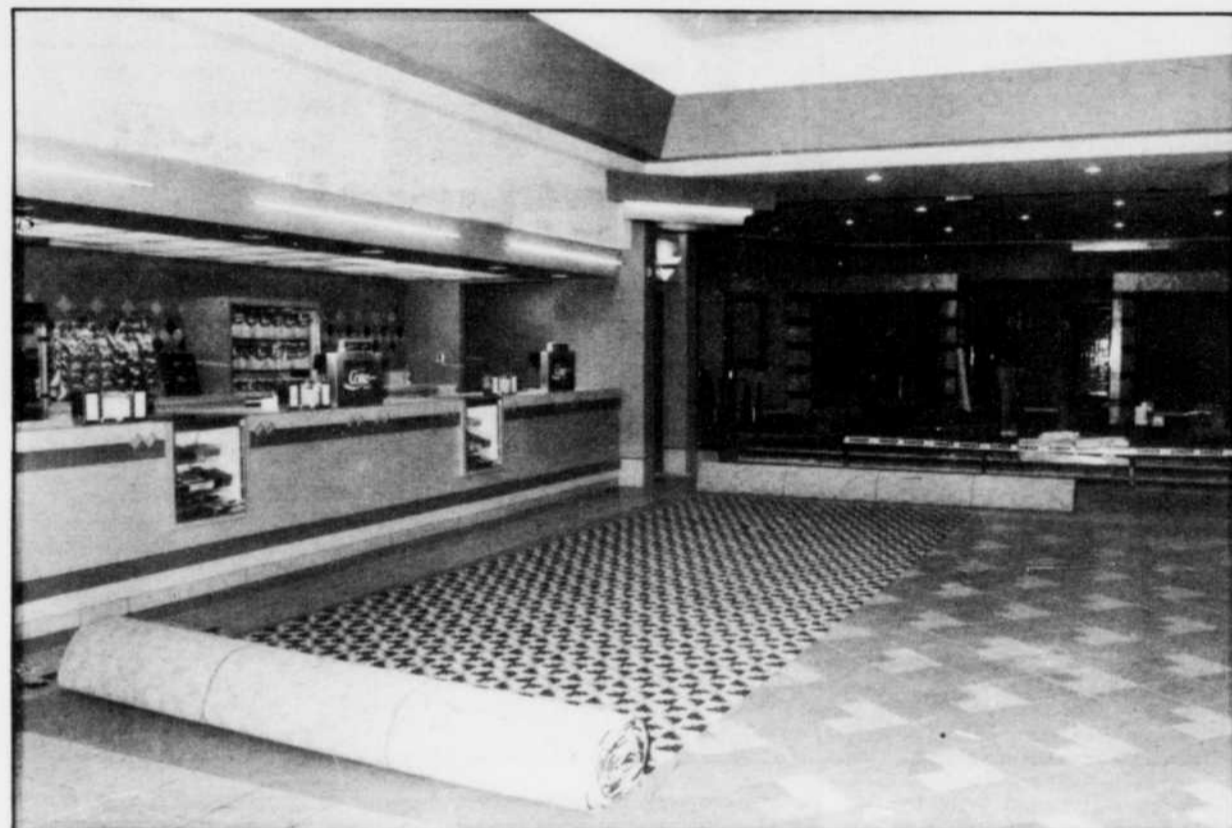
Travaux en cours dans le hall d'entrée du cinéma Fleur de Lys. Le comptoir des rafraîchissements se trouve situé entre les différentes salles de projection.
