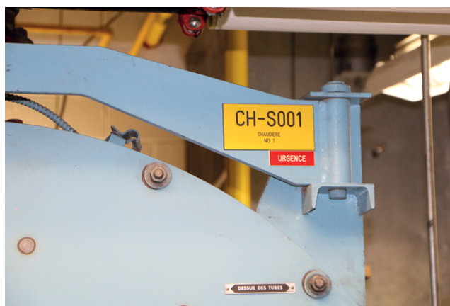
Exemple d'identification de l'appareillage
