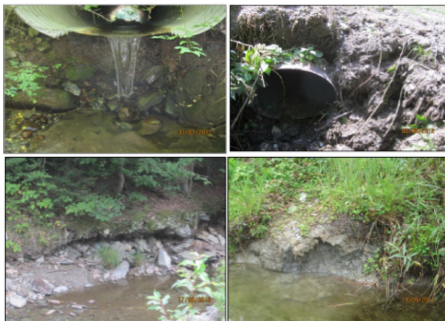
Figure 3.34: Exemples de problématique d'érosion ou défauts observés aux traverses
