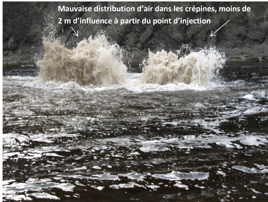
Figure 9 : Étape 2 – Injection simultanée d'air et d'eau dans les crépines
