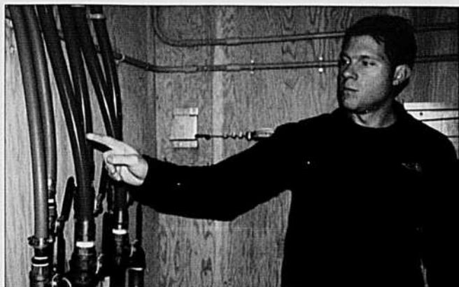
Après la salle de la chaudière, l'eau chaude est transportée par des tuyaux qui s'acheminent dans différents endroits du poulailler.
