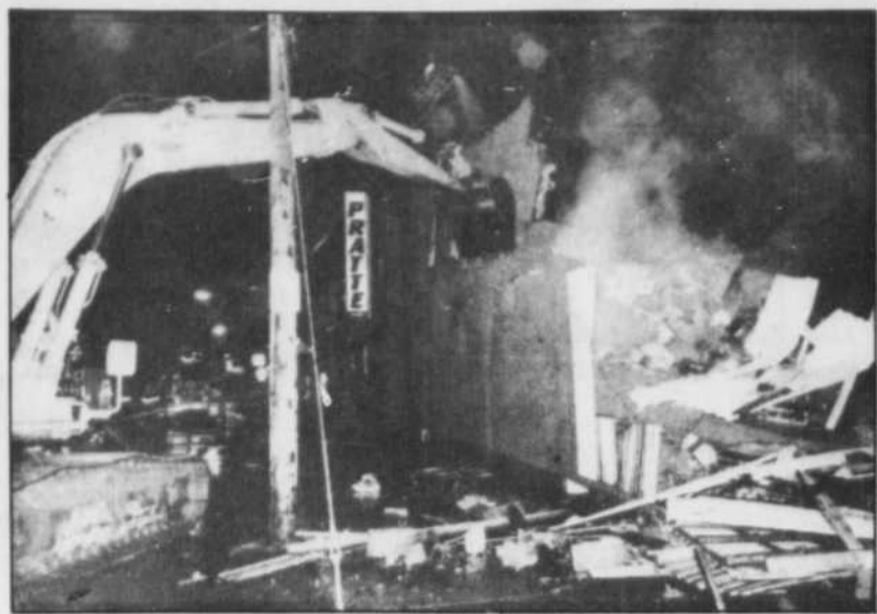
On a utilisé une pelle mécanique pour pousser les ruines sur le terrain du magasin afin d'éviter qu'elles se retrouvent sur le trottoir ou sur la rue. (Photo Yves Champoux)
