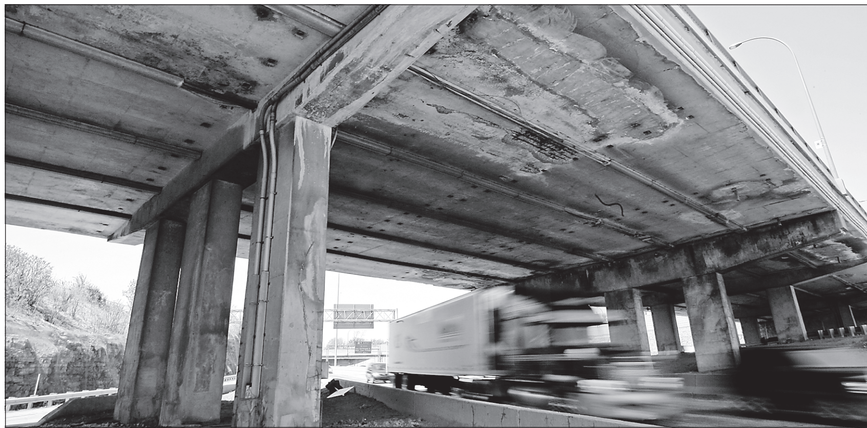
La décision de fermer le viaduc complètement aurait été prise après une inspection de la structure et pour des raisons de sécurité, a indiqué une source au Ministère. PHOTO ROBERT SKINNER. LA PRESSE ©
