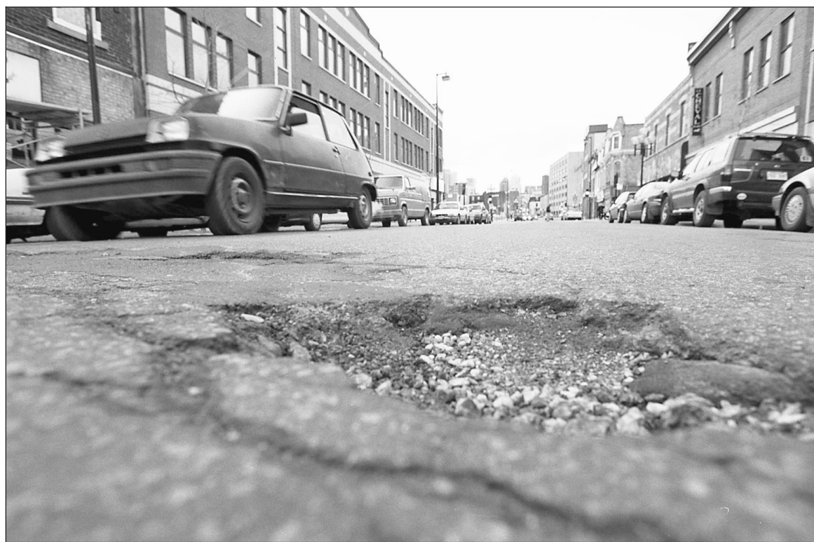
Depuis le 14 mars, une centaine de cols bleus de Montréal colmatent les trous de la chaussée (ci-dessus, rue Ontario) en les remplissant d'asphalte. Tous les jours, 100 tonnes d'asphalte sont ainsi utilisées.
