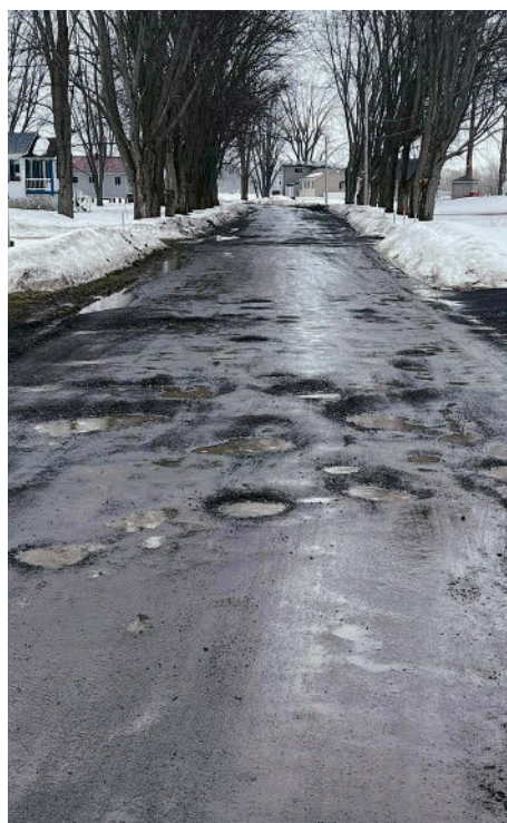
La chaussée du rang de la Pointe-au-Nord-Est est parsemée de trous. Photo tirée de Facebook
