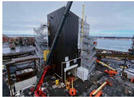
La nouvelle usine BlueSmelting MC est maintenant opérationnelle sur le site de Rio Tinto Fer et Titane à Sorel-Tracy.
