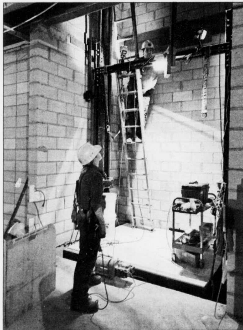
Tous les jours, entre 100 et 150 travailleurs envahissent l'école secondaire Kénogami. Si tout se déroule selon l'échéancier, elle devrait être prête pour la rentrée scolaire 2009.
