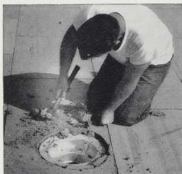
FACILE À METTRE EN FORME autour des trous pour assurer le libre écoulement des eaux.
