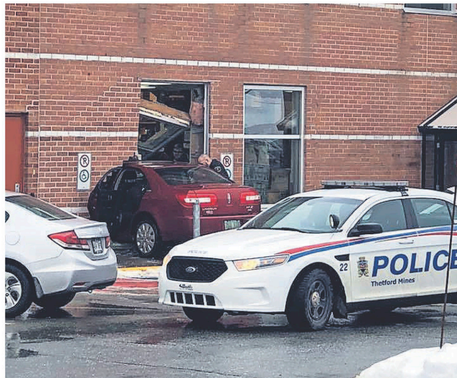
Les dommages sont évalués sommairement à 10 000 $. (Photo gracieuseté - Sébastien Lambert Grenier)
