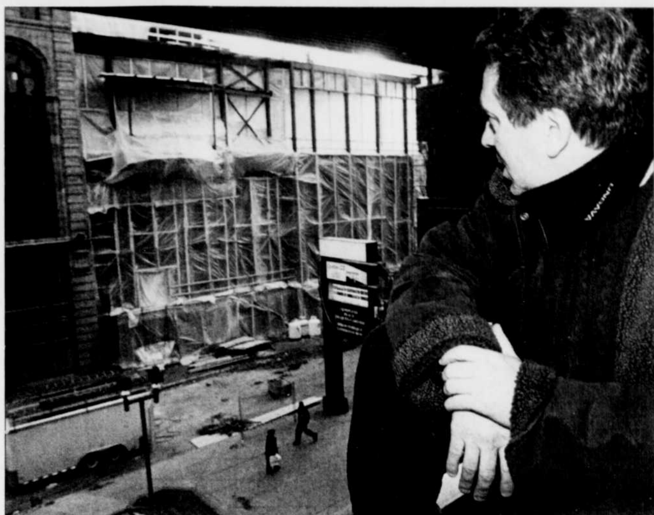
La compagnie aura mis un quart de siècle à fouler sa terre promise. L'inauguration de sa nouvelle salle, rue Saint-Joseph, le 19 mars, constituera le point d'orgue de cette saison historique. Jack Robitaille contemple l'ampleur des travaux.
