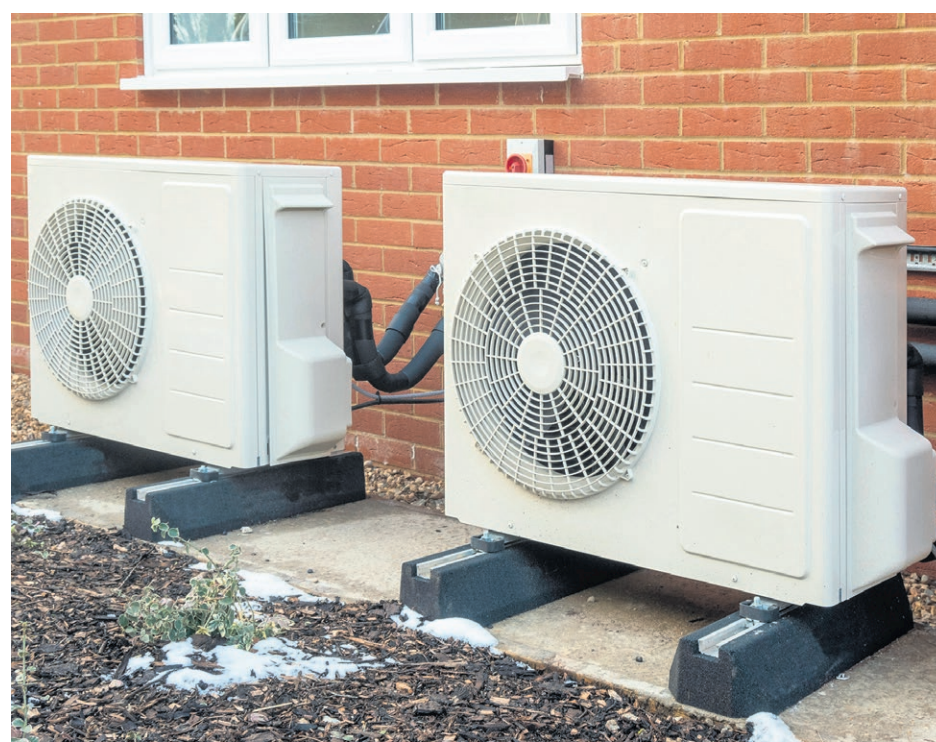
Les thermopompes offrent une solution viable et écoénergétique. Photo Adobe Stock
