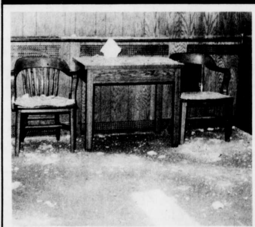
Un morceau de plâtre s'est détaché du plafond d'une salle publique pendant la nuit au vieux palais de justice de Sherbrooke et les débris sont tombés sur des chaises. Il s'agit du quatrième incident du genre à survenir à cet endroit au cours des dernières années. Personne n'a cependant été blessée jusqu'ici. On se rappellera que le ministère des Travaux publics doit refaire une partie de la toiture de l'immeuble qui date de 1903.
