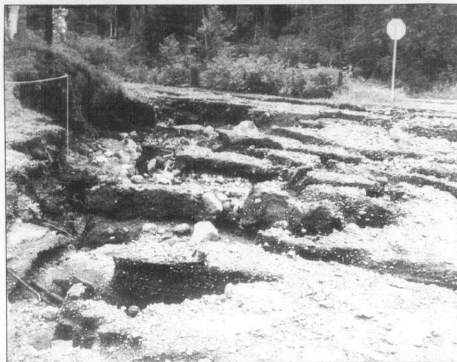
LAC VERT - Dans le secteur du rang Lac Vert, à Hébertville, une partie de route a été complètement rongée par l'érosion provoquée par les pluies qui descendaient de la montagne.
