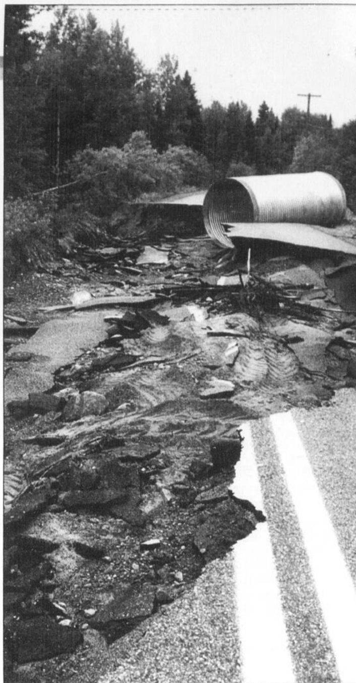
DEGATS - Une photographie qui montre bien la poussée effectuée par l'eau au cours des derniers jours. Le chemin Saint-André à Métabetchouan a été littéralement scié par la force du courant.
