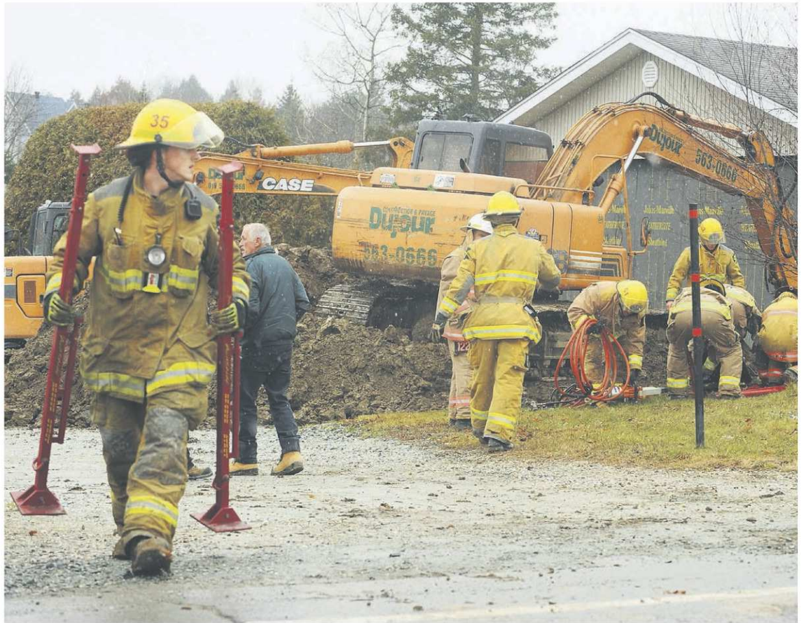
L'enquête menée sur les lieux de l'accident qui a coûté la vie à un travailleur, vendredi, exclut la négligence dans l'exécution des travaux.
