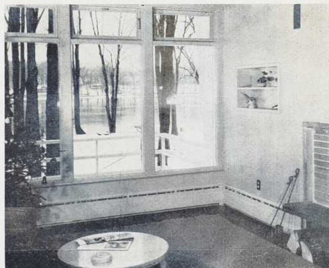
Radiateur à plinthes dans une résidence. L'appareil couvre le long du mur et sous les fenêtres.
