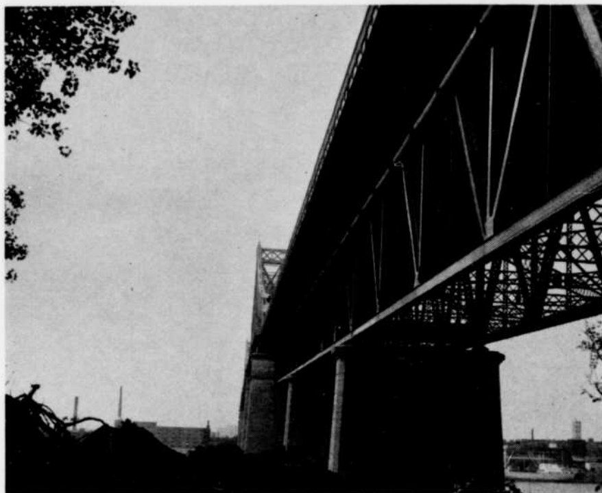
Le gazoduc de la rive sud en place sous le tablier du pont Jacques-Cartier. Vue prise de l'île Ste-Hélène.
