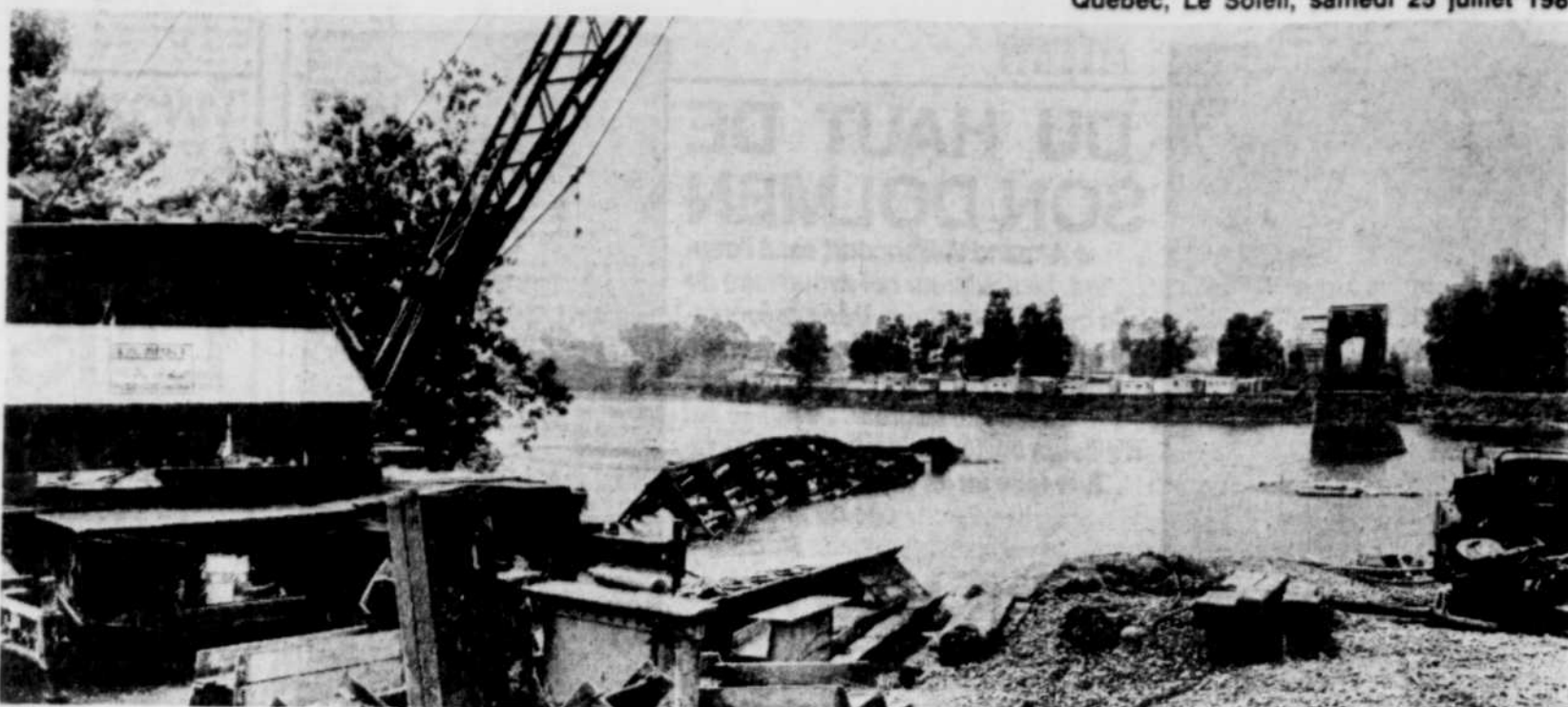
Trois des six sections du pont du CP ont été emportées par la crue des eaux de la Sainte-Anne, le 1er avril. Une portion de la travée centrale repose encore dans deux mètres d'eau.
