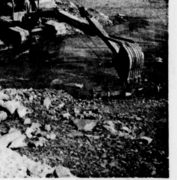
LA PREMIERE ETAPE est en voie de réalisation pour le projet de filtration de l'eau à l'aqueduc municipal de Princeville. Il s'agit de l'installation d'une conduite d'aménée d'une longueur d'environ 5,000 pieds, entre l'usine de pompage actuelle et la future unité qui puisera l'eau dans des tuyaux filtrants enfoncés dans le sous-sol, près de la rivière. Sur la photo, on remarque les puissantes machines ouvrant une tranchée dans la rivière Bulstrade, qui doit être traversée pour la conduite d'aménée. Cette partie des travaux a été confiée à P. Poirier Construction Inc., de Princeville.
