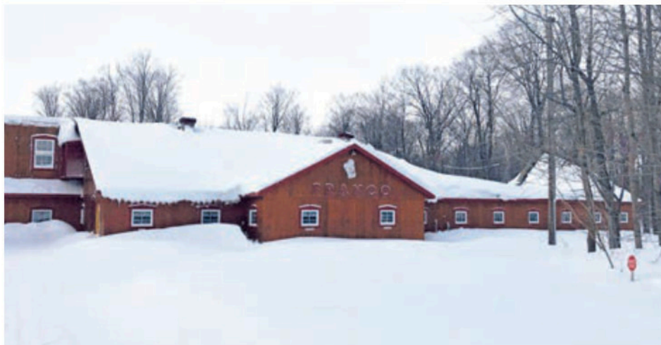
Une partie de la toiture, à droite, s'est effondrée en raison de la neige à l'érablière Franco. (Photo La Voix du Sud - Éric Gourde)
