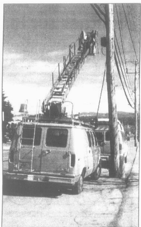
L'installation du câble coaxial le long de centaines de kilomètres de routes dans les Cantons-de-l'Est et la Beauce nécessite l'intervention de plusieurs équipes de techniciens. (Photo L'Écho)
