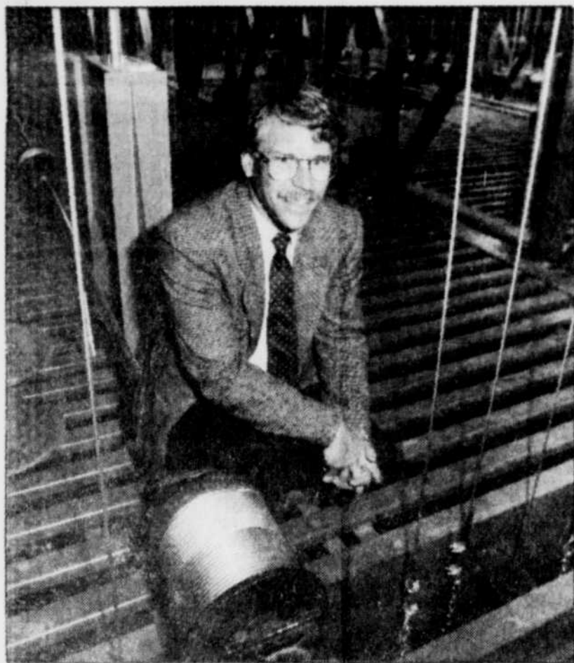
Le directeur général Sylvain Gagné, au « grenier » de la salle Albert-Rousseau, située à une soixante de pieds du sol : 60 kilomètres de câbles supportent les différents équipements de la scène.
