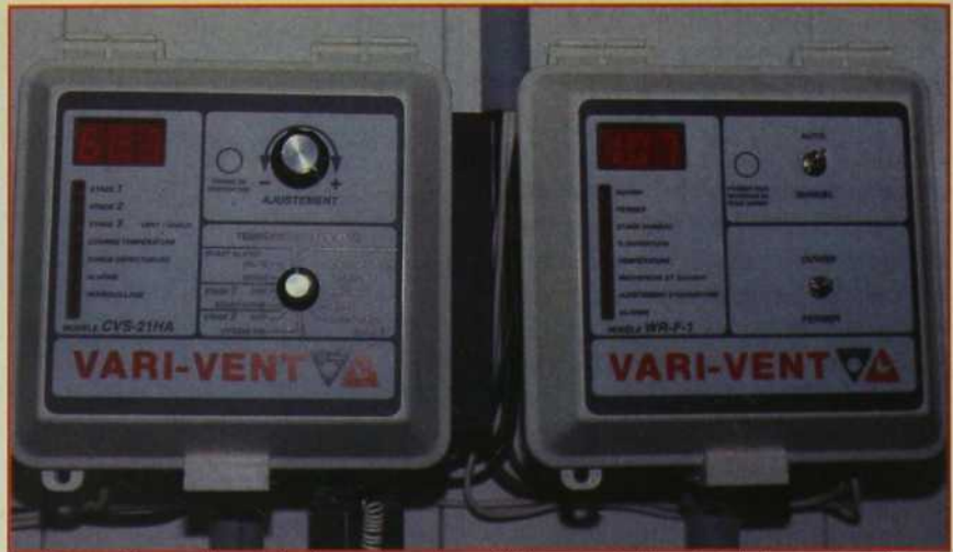
Un contrôle supplémentaire du système de ventilation permet d'ouvrir et de fermer les prises d'air en fonction du nombre de ventilateurs en opération et de l'air en mouvement.
