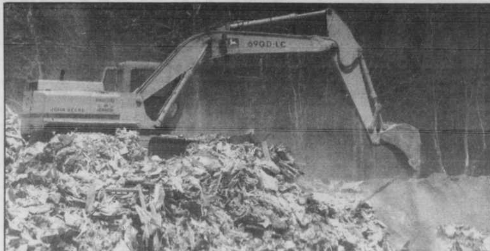
Les inspecteurs du MENVIQ ont visité le dépôt de matériaux secs de Bonsecours.
