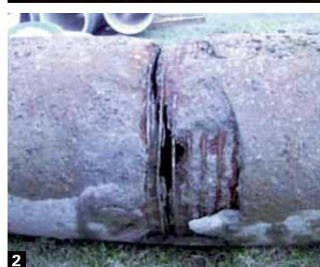
1 Tuyau en fonte perforé par la corrosion.
