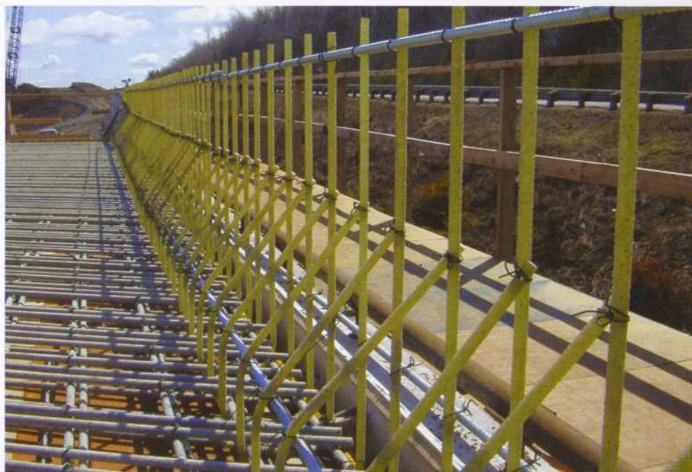
Pont en béton armé dont les barres d'armatures sont en matériaux composites.
