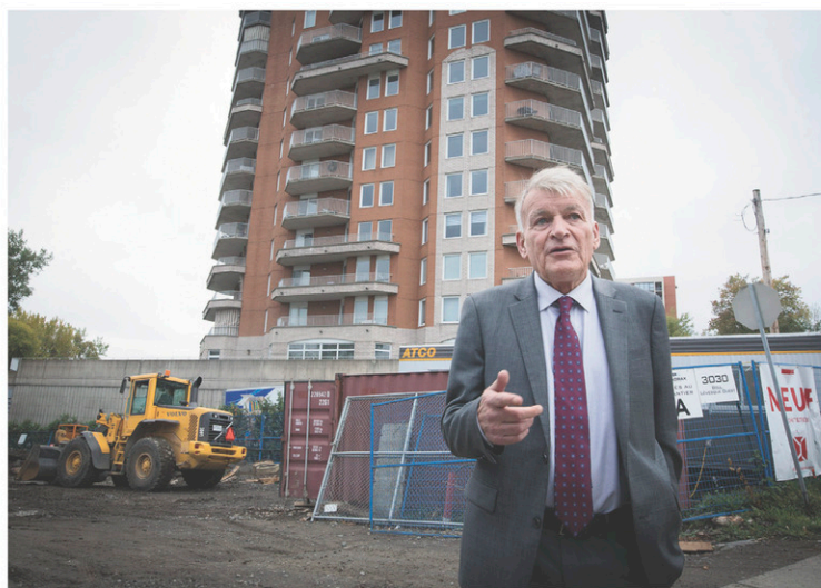
Selon Jean-Claude Gobé, une tour d'habitation de 26 étages, en chantier en bordure de la rivière des Prairies, démontre que le maire Demers n'a pas fait le ménage promis à l'Hôtel de Ville.
