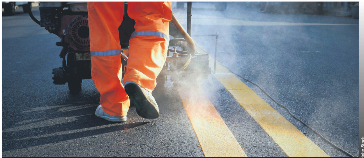
La route 321 Nord à L'Ascension est un exemple de reconstruction d'une route, dans ce cas précis, sur une longueur d'environ 7 kilomètres. Le ministère des Transports est au fait, mais quand va-t-il procéder?
