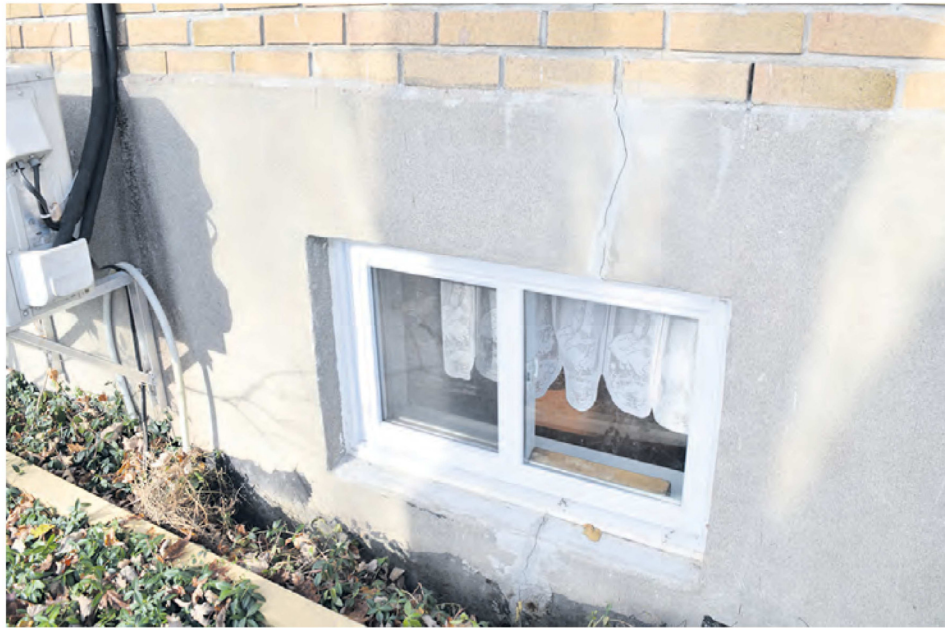
Saint-Basile-le-Grand est aux prises avec plusieurs cas de fissures de fondations. (Photo : archives)
