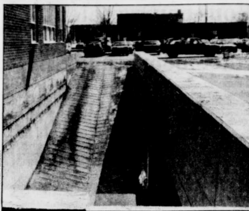
La sortie illégale du Beau-Bourg amputerait huit espaces sur le stationnement de l'hôtel de ville de Sillery, une dérogation au permis de construction.
