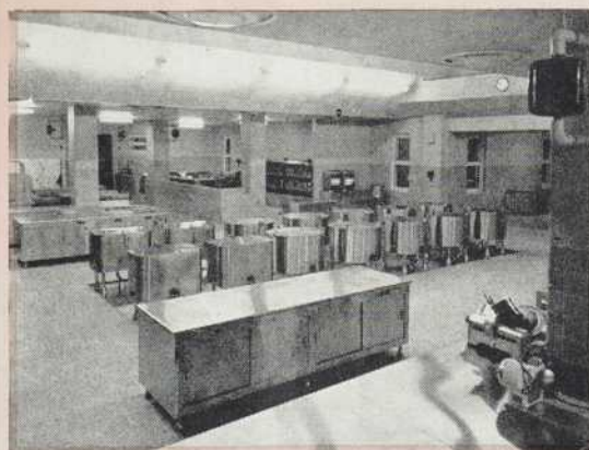
Hôpital du Sacré-Cœur, Cartierville, P.Q. Cuisine Centrale
