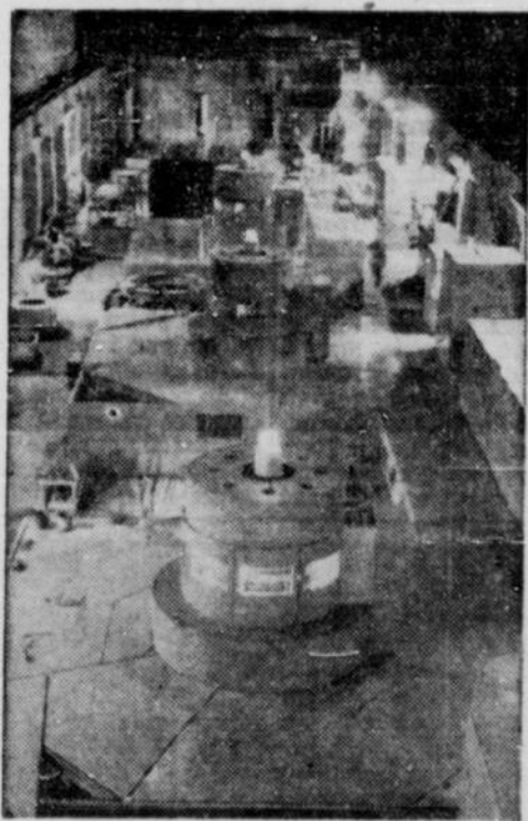
La centrale, où trois groupes générateurs de 150,000 chevaux chacun sont déjà en exploitation.
