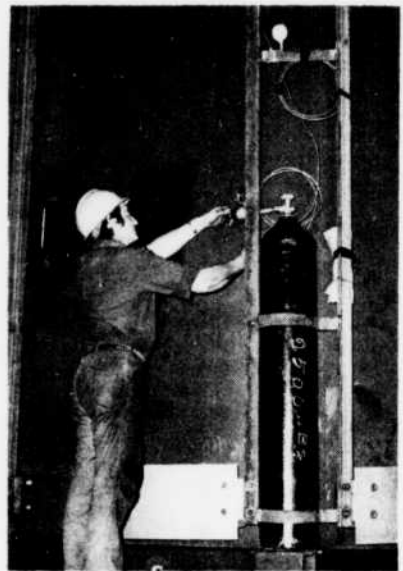
PLEINS D'AZOTE A 2 LIVRES DE PRESSION , ces deux transformateurs voyagent avec chacun deux bonbonnes de secours. Claude Larouche, mécanique d'entretien, vérifie le fonctionnement des valves de contrôle et des manomètres indicateurs.
