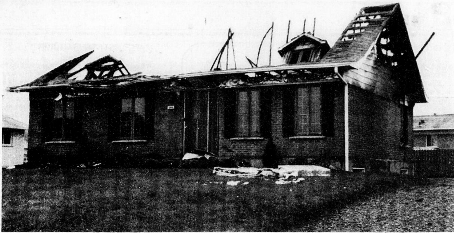
DOMMAGES — La toiture de cette jolie demeure de la rue des Pluviers n'est plus que cendres, après l'incendie qui y faisait rage, hier, en après-midi.
