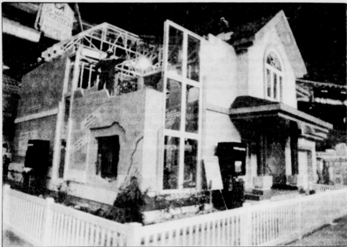
La maison Contech présente des technologies nouvelles dont la structure de béton avec coffrage en polystyrène et un système central de domotique qui gère l'énergie et l'éclairage.
