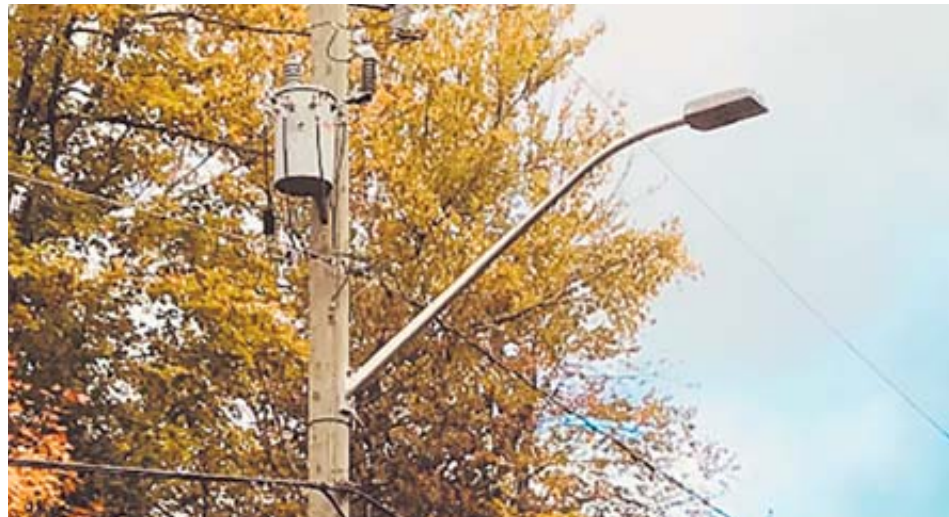
Les luminaires actuels seront remplacés par un modèle qui sera muni d'ampoules à diodes électroluminescentes (DEL).
