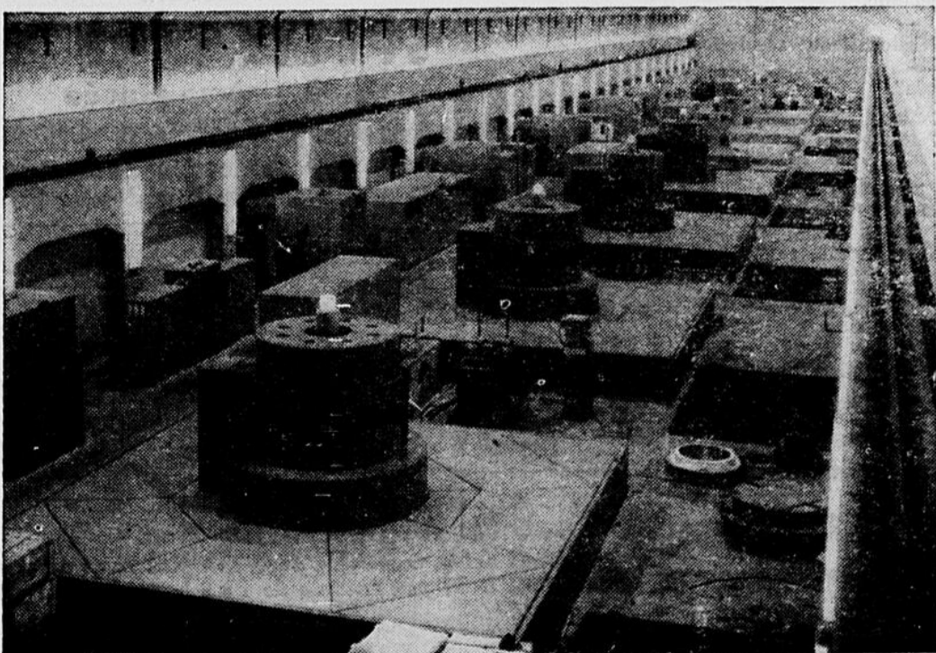
La centrale BERSIMIS-UN montrant les huit groupes générateurs, de 150,000 chevaux chacun, raccordés à la ligne de transport reliant Bersimis, Québec et Montréal.
