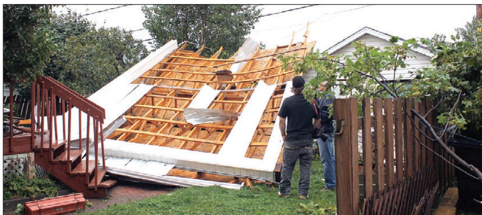
Les forts vents ont fait voler des toitures et des remises dans le secteur Les Rivières.
