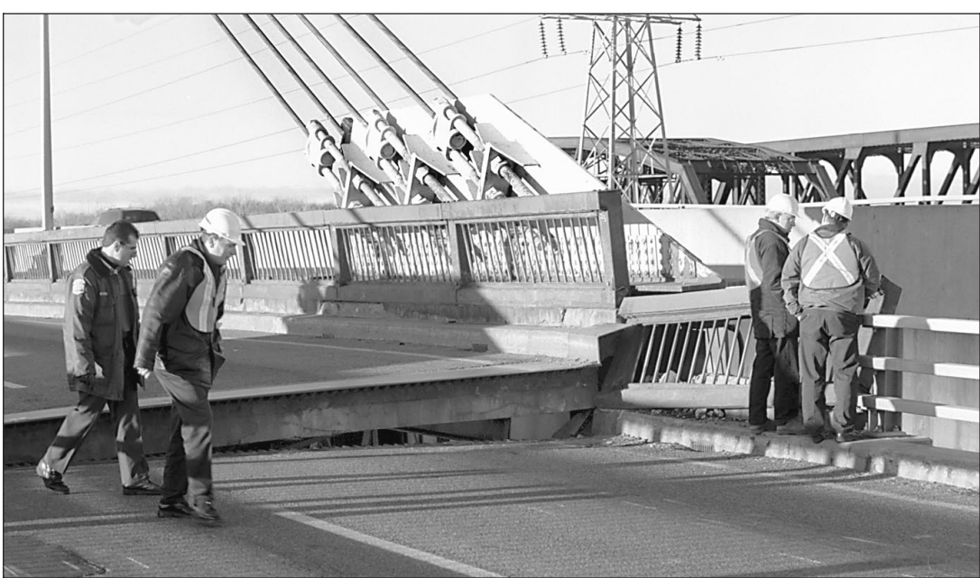
PHOTOTHÈQUE, La Presse La fermeture partielle du pont Galipeault risque de durer deux semaines en raison de l'ampleur des travaux de réparation de la structure.
