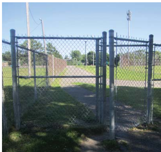
Accès problématique Parc Daniel-Johnson, arrondissement Saint-Hubert
